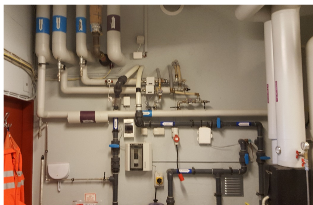
Afgrening til pool anlæg i vekslerum
