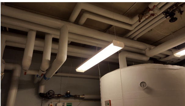
Vand og varmerør over VVB
