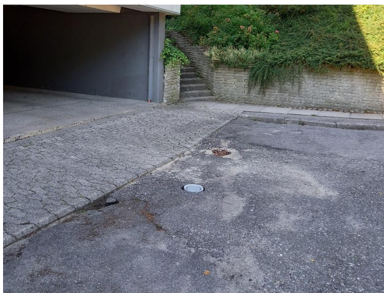
Figur 2.1 Sætningsskadet asfalteret område
