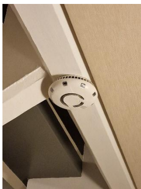
Røgalarmer i opgange.
